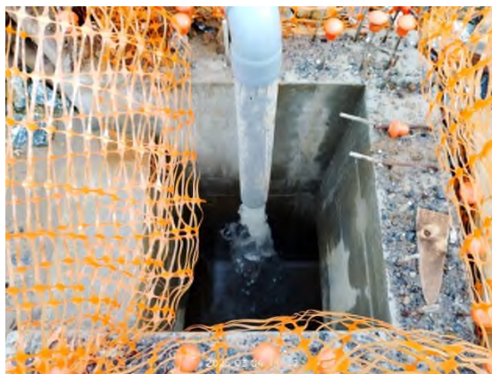
Foto nº15: Vertido de la depuradora
