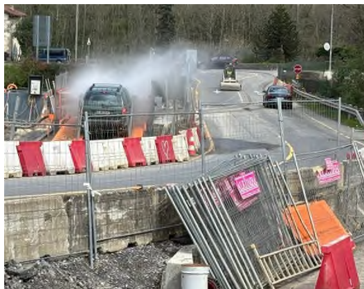
Foto nº34: Barredora en la zona de Etxebarria
