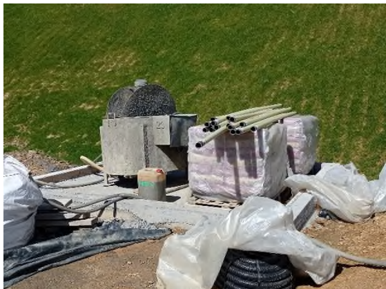
Foto nº29: Punto de acopio aislado hidráulicamente en Etxebarria
