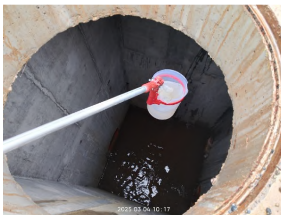
Foto nº41: Salida del dren de fondo
